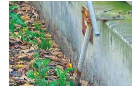
Verrostete Schieber: ersetzen!
