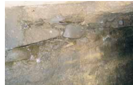
Bröckelnder Verputz Sanierung notwendig.
